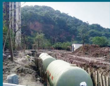
杭州滨江区浦乐地块 雨水收集系统
