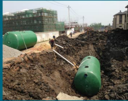
昆山五宝湖 生活污水一体化工程
