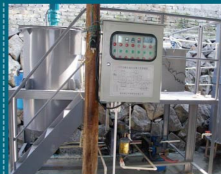
龙泉汽配工业园磷化 废水处理工程
