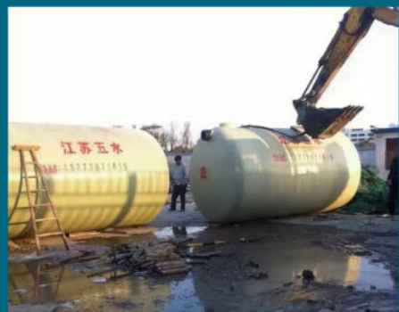
乐清金凯金悦大厦 生活污水处理
