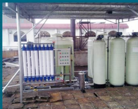
福建三金钢铁公司 中水回用系统
