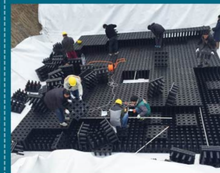
中建四局商业办公楼 雨水收集项目
