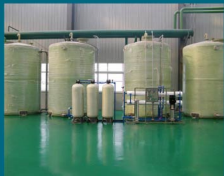
安徽天象环保纸业公司 污水治理工程
