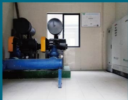
嘉兴市第二人民医院 污水处理工程
