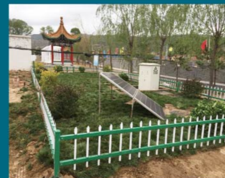
山西吕梁秦家崖村 MBR一体化示范工程
