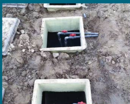
杭州富阳新农村 雨水收集利用工程
