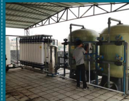
浙江海宁机电厂300TD 污水处理项目
