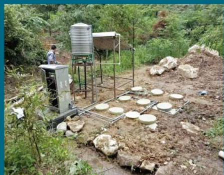
湖州市罗汉村文化礼堂 一体化污水终端
