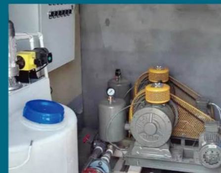
浦口街道社区卫生服务中心 医疗废水处理项目
